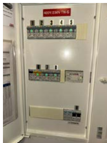
Sikringsskap med automatsikringer.
