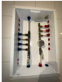
Samleskap med rørkurser og stoppekraner
