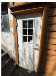
Noe "svelling" i overflater i dør til kjeller
