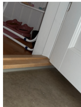
Eksempel på synlig skade i hjørne.
