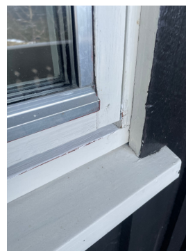
Vindu med værslitt/sprekker i treoverflate
