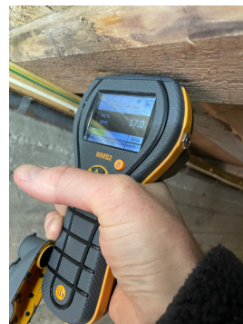
Ved stikkprøver måles det 17 vektprosent fukt.
