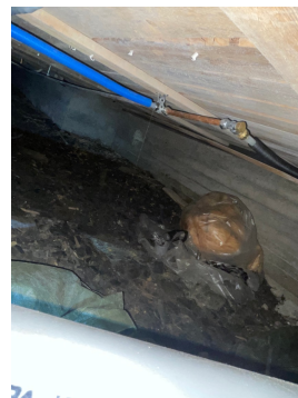
Manglende fuktsperre mot grunn
