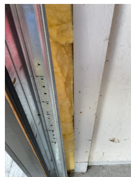
Manglende ferdigstilling som eier nå har utbedret.
