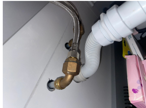
Rørgjennomføringer i våtsone mangler rør-mansjetter.
