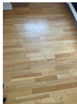
Sår og hakk i overflater på gulv
