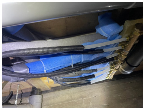
Rørkurser er ikke merket
