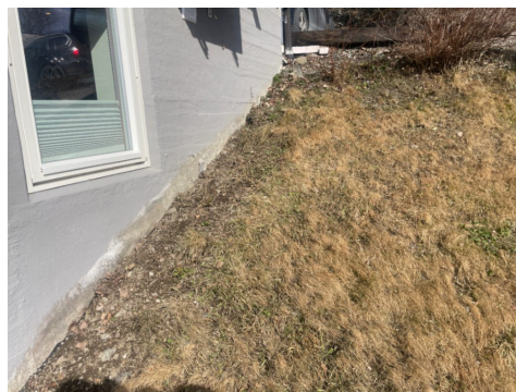
Stedvis noe synlig knotteplast på kortvegg mot sør.
