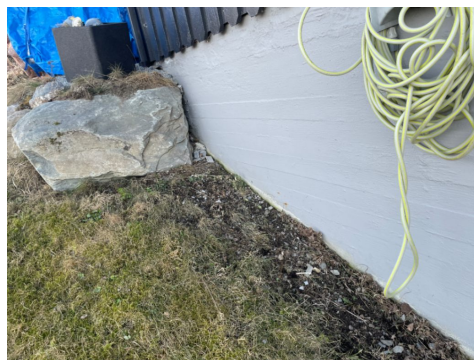
Ikke synlig knotteplast på kortvegg mot nord.
