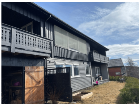
Stedvis værslitt overflate på ytterkledning.
