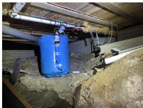
Synlige kobberør med irret overflate
