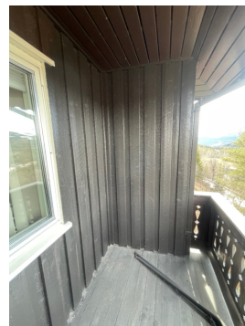
Værslitte flater på golv og rekkverk.
