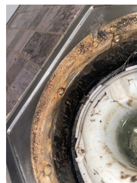
Sluk i dusj med synlig tettesjikt under klemring
