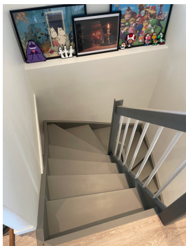
Manglende håndløper i trappeløp.
