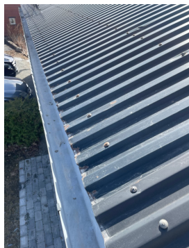
Sår i overflatebehandling/stedvis mindre bulker.
