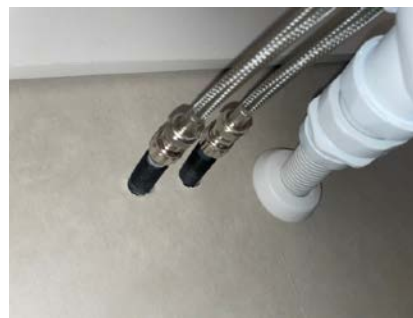
Eksempel på manglende tettemuffer på varerør
