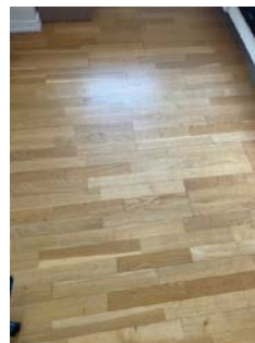
Sår og hakk i overflater på gulv
