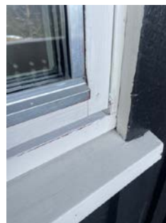
Vindu med værslitt/sprekker i treoverflate
