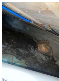
Manglende fuktsperre mot grunn
