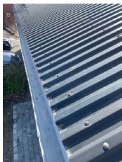
Sår i overflatebehandling/stedvis mindre bulker.
