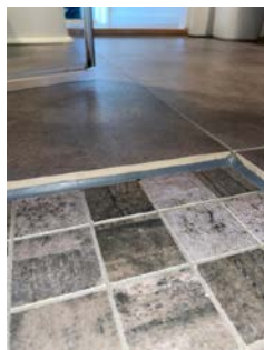
Nedsenk i dusj og synlig terskel m/fug i bakkant.
