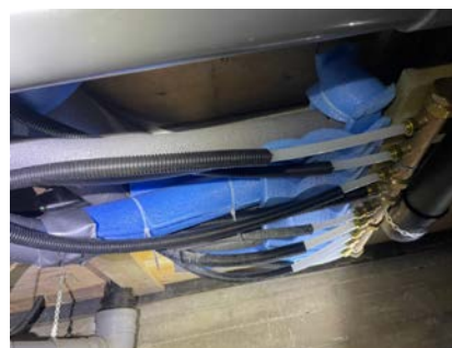
Rørkurser er ikke merket
