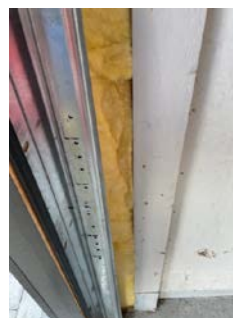
Manglende ferdigstilte som eier nå har utbedret.
