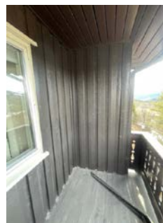
Værslitte flater på gulv og rekkverk.
