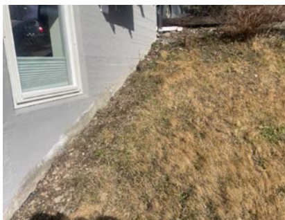
Stedvis noe synlig knotteplast på kortvegg mot sør.
