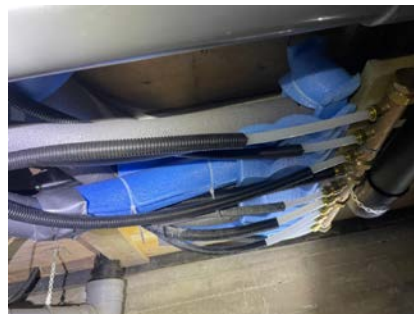
Samlestokk for vann ligger rett under vaskerommet
