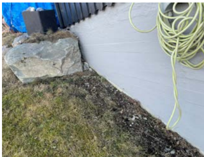
Ikke synlig knotteplast på kortvegg mot nord.
