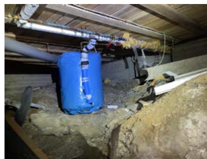
Synlige kobberrør med irret overflate
