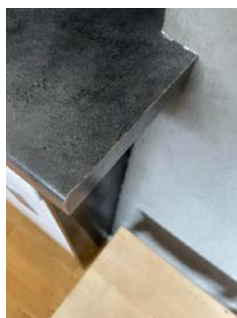
Mindre sår i laminat på enden av benkeplate
