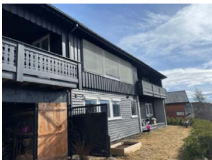
Stedvis værslitt overflate på ytterkledning.
