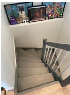
Manglende håndløper i trappeløp.
