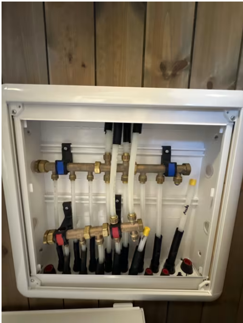
Vannrør med rør i rør system fra fordelerskap plassert i bod og frem til sanitærinstallasjoner på badetrom, toalettrom og kjøkken. Nederste fordeler er løs. Må festes tilstrekkelig.
