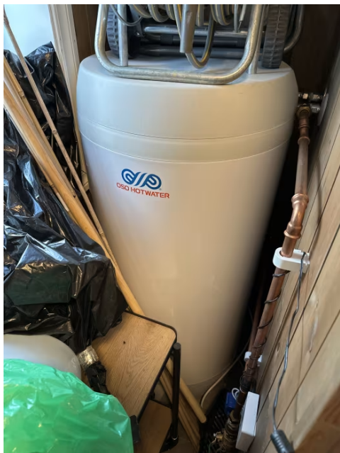
Viser bereder plassert i bod.
