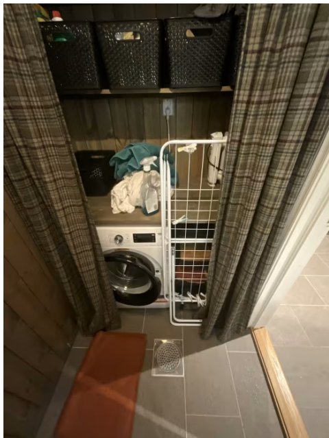
Viser sluk og opplegg for vaskemaskin.
