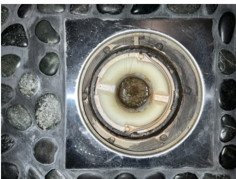
Viser sluk i dusjsonen.
