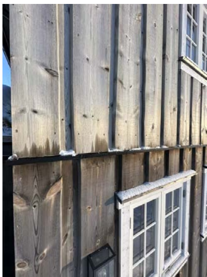
Større avstand mellom kledning og beslag anbefales etablert for å unngå fuktopptrekk.
