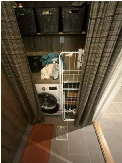
Viser sluk og opplegg for vaskemaskin.
