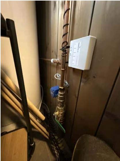
Viser vanninntak og hovedstoppekran i bod.
