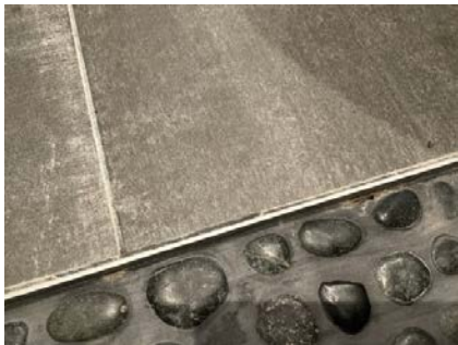
Viser sprekker i fuger i dusjsonen. Lokal utbedring må påregnes.
