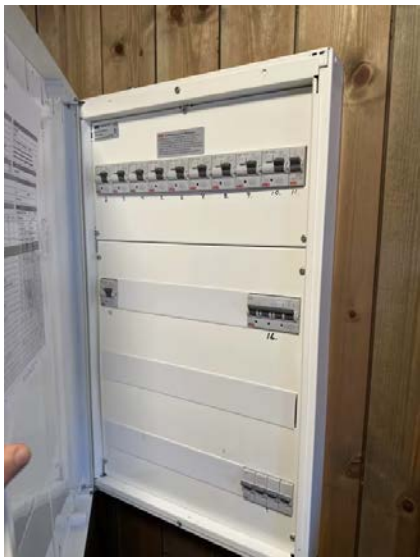
Viser innfelt sikringskapp plassert i bod.
