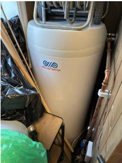
Viser bereder plassert i bod.
