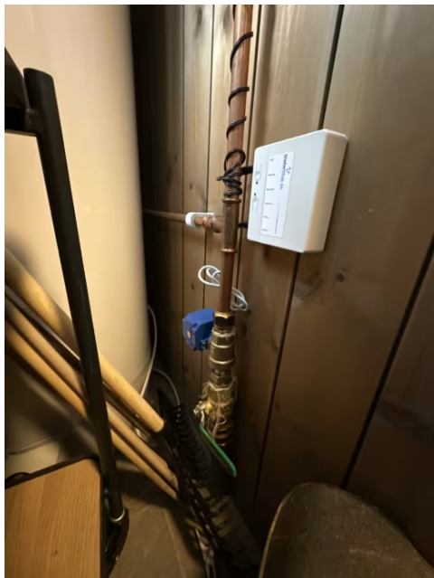
Viser vanninntak og hovedstoppekran i bod.
