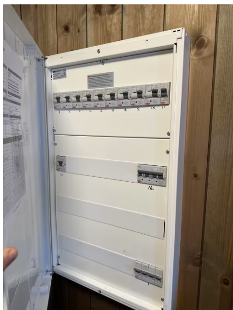
Viser innfelt sirkingskapp plassert i bod.
