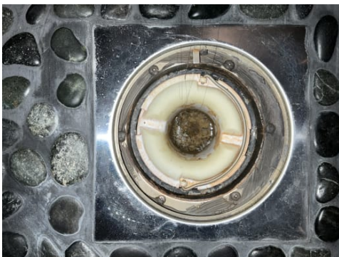
Viser sluk i dusjsonen.
