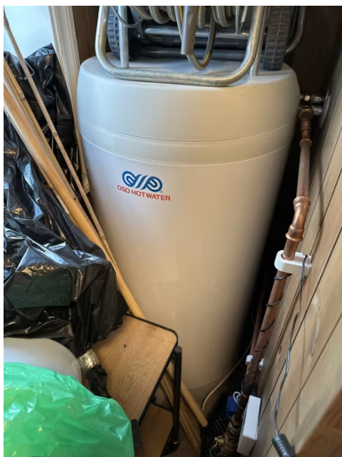
Viser bereder plassert i bod.
