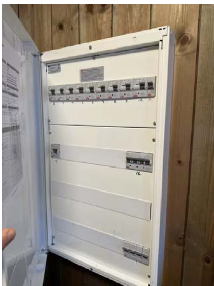
Viser innfelt sikringskapp plassert i bod.
