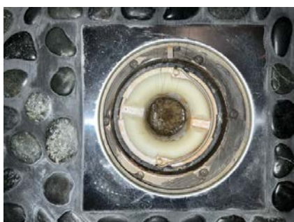
Viser sluk i dusjsonen.
