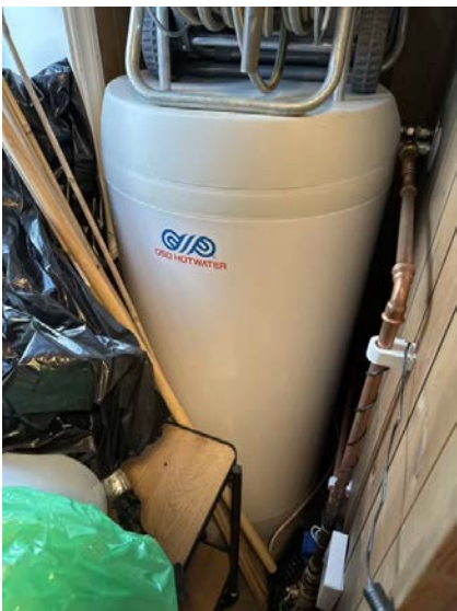
Viser bereder plassert i bod.
