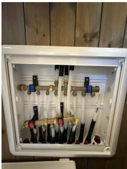
Vannrør med rør i rør system fra fordelerskap plassert i bod og frem til sanitærinstallasjoner på badetrom, toalettrom og kjøkken. Nederste fordeler er løs. Må festes tilstrekkelig.
