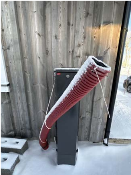
Viser inntakskap og elbillader. Trekkerør ført til anneks.
