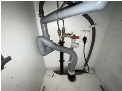
Viser vann og avløpsinstallasjoner under kum.
