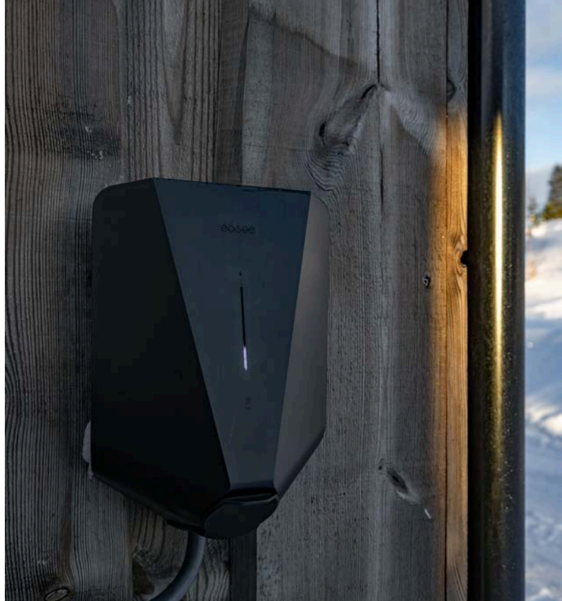
Det er installert elbil-lader på husveggen.
