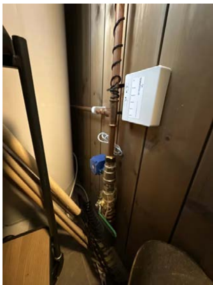
Viser vanninntak og hovedstoppekran i bod.
