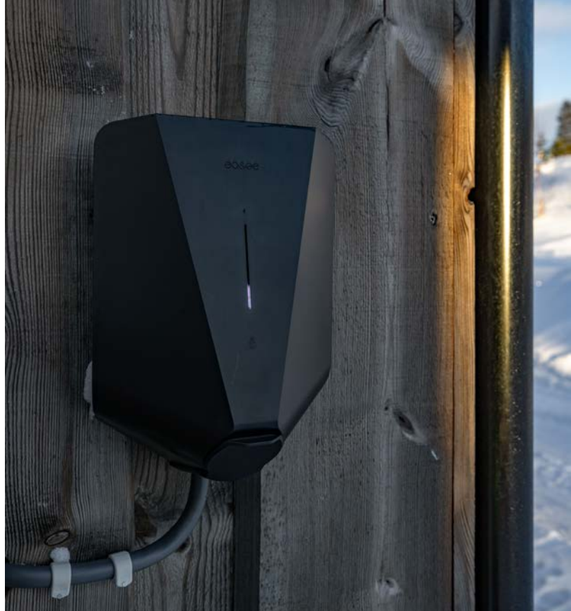
Det er installert elbil-lader på husveggen.
