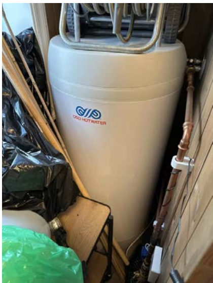
Viser bereder plassert i bod.
