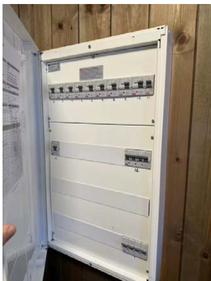
Viser innfelt sikringsskap plassert i bod.
