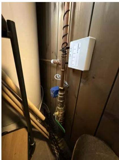
Viser vanninntak og hovedstoppekran i bod.
