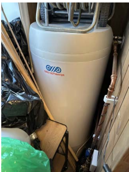
Viser bereder plassert i bod.
