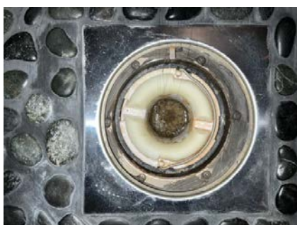
Viser sluk i dusjsonen.
