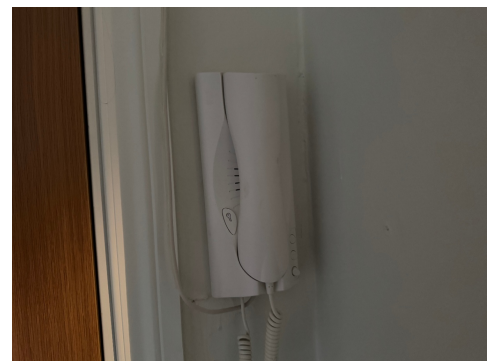
Dørtelefon i entre/gang.
