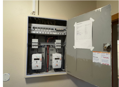
Sikringsskap i fellesarealer.
