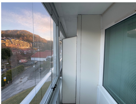
Skillevegg mellom nabo går ikke helt opp til tak.
