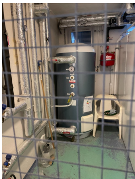
Felles varmesentral/varmtvannstank i u-etg.
