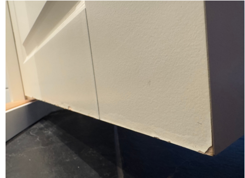
Fuktutsvelling/slitasje i nedre del av badedør.
