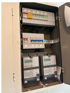
Sikringsskap med automatsikringer.
