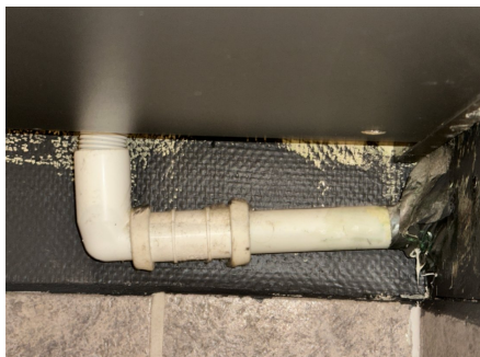
Avløpsrør under servant på bad
