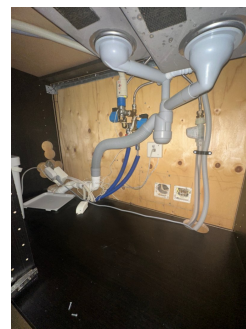
Rørøpplagg i kjøkkenbenk med Waterguard
