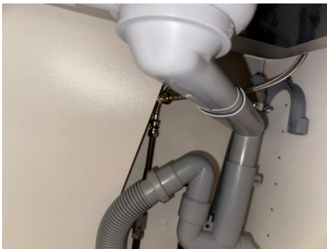
Rørapplegg i kjøkkenbenk
