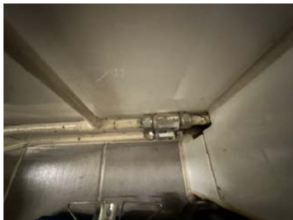
Stoppekraner plassert på bad
