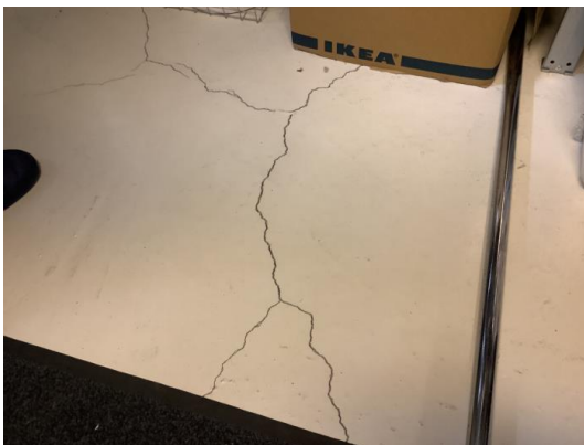
Sprekker i støpt kjellergulv.
