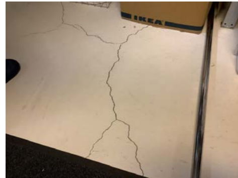
Sprekker i støpt kjellergulv.
