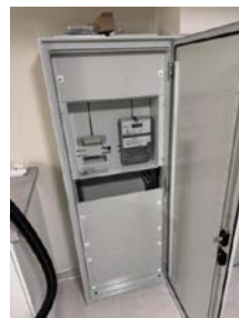
Strømmåler plassert i kjelleren.
