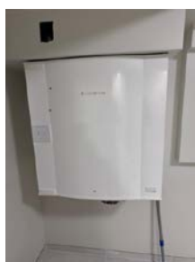
Ventilasjonsaggregatet er montert i kjelleren.
