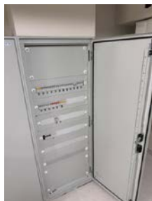
Sikringsskapet er plassert i kjelleren.
