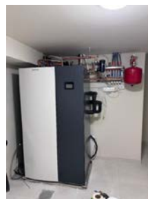
Varmepumpe montert i kjelleren.
