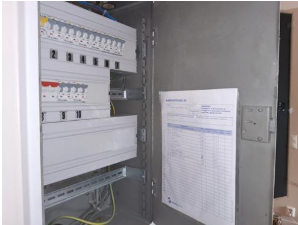
Beskrivelse - [Sikringsskap med kursfortegnelse. ]
