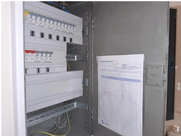
Beskrivelse - [Sikringsskap med kursfortegnelse. ]
