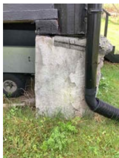
Skjevhet på enkelte fundamenter.
