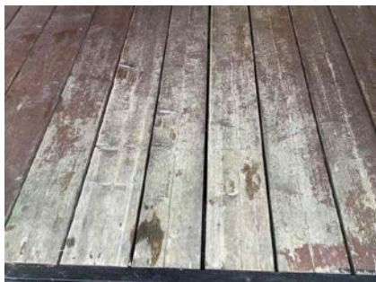
Slitasje på gulv.
