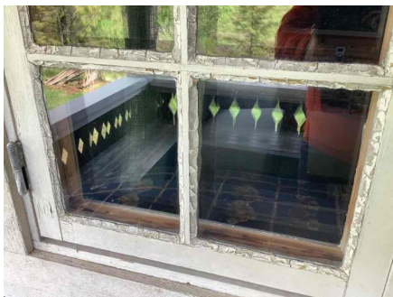
Eksempel på slitasje og oppsprekking i kitt.
