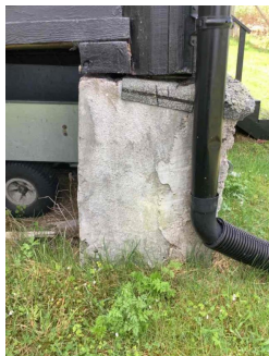
Skjevhet på enkelte fundamenter.
