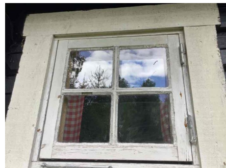
Eksempel på slitasje.
