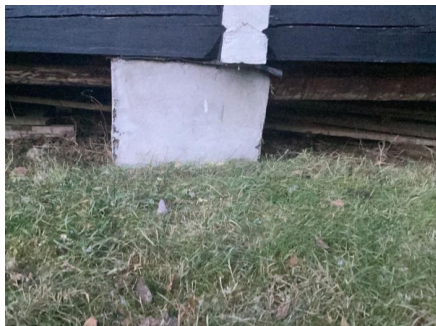
Eksempel på fundament med skjevhet.
