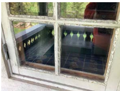
Eksempel på slitasje og oppsprekking i kitt.
