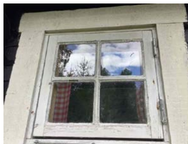
Eksempel på slitasje.
