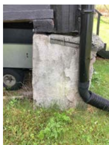
Skjevhet på enkelte fundamenter.
