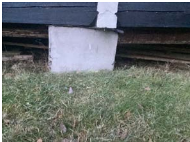
Eksempel på fundament med skjevhet.
