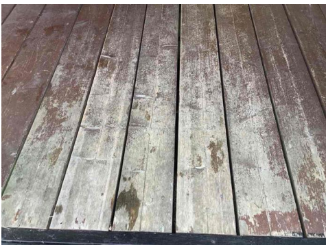
Slitasje på gulv.
