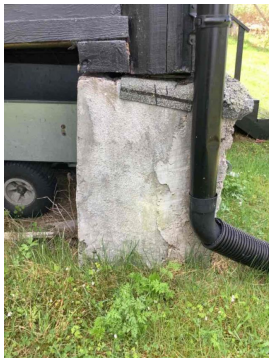
Skjevhet på enkelte fundamenter.
