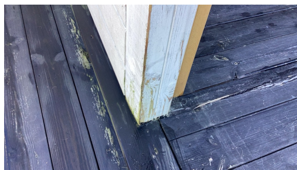
Eksempel på slitasje.
