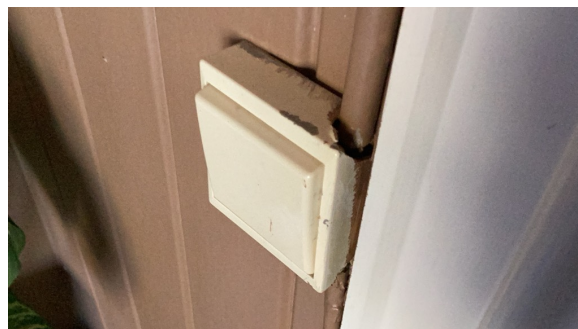
Eksempel på forhold som vil medføre avvik ved en eventuell el-kontroll.
