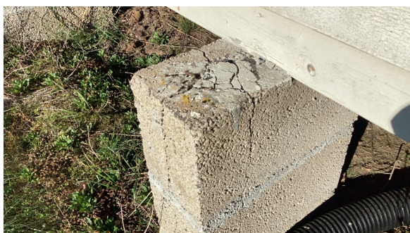
Eksempel på sprekk i fundamenteringsblokk.
