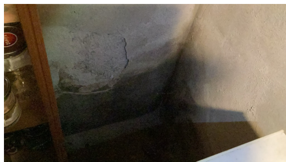
Eksempel på misfarging og avskaling.
