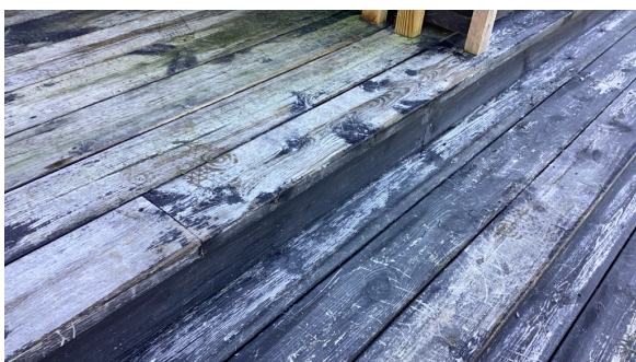
Eksempel på slitasje.
