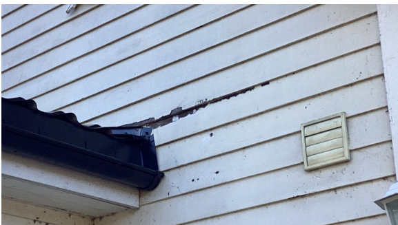
Eksempel på avskaling av maling.
