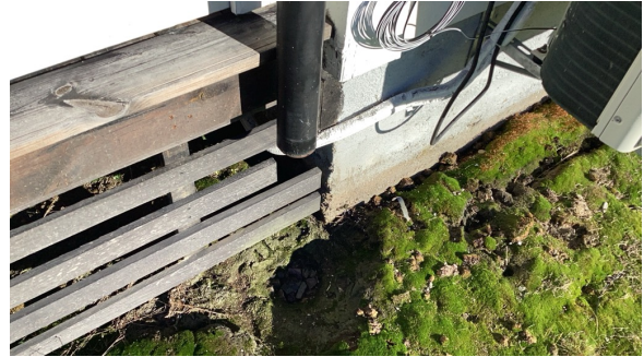
Takvann ledes ikke bort fra alle steder rundt bygget.
