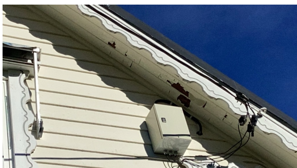
Eksempel på slitasje.
