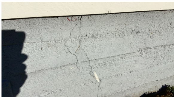
Eksempel på sprekk i grunnmur.
