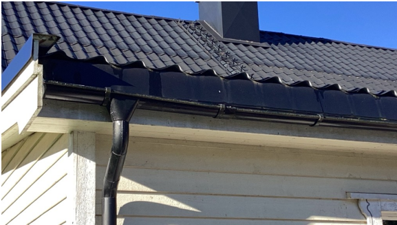
Nedbøyning på takrenne.
