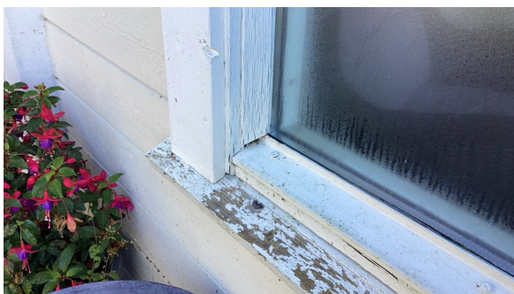
Eksempel på slitasje.
