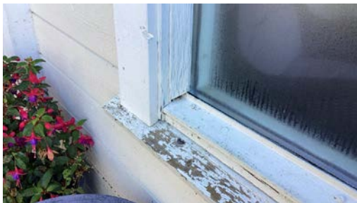
Eksempel på slitasje.
