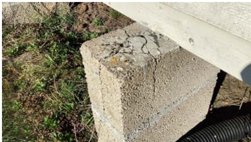
Eksempel på sprekk i fundamenteringsblokk.
