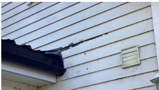
Eksempel på avskaling av maling.
