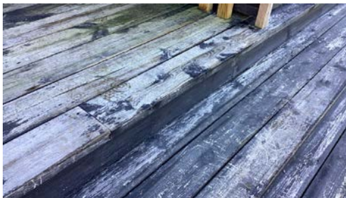
Eksempel på slitasje.
