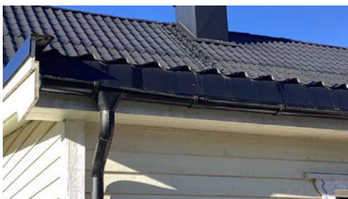
Nedbøyning på takrenne.
