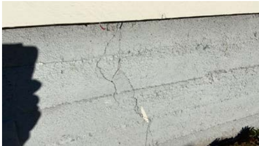
Eksempel på sprekk i grunnmur.
