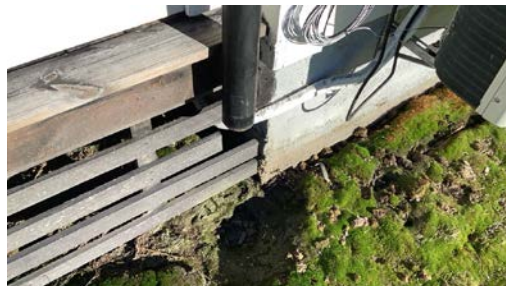
Takvann ledes ikke bort fra alle steder rundt bygget.
