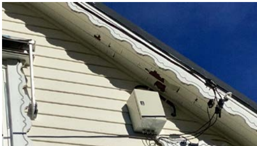
Eksempel på slitasje.
