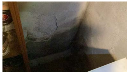
Eksempel på misfarging og avskaling.
