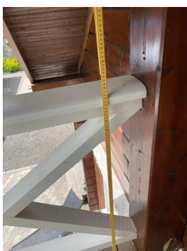
Høyde og åpninger på veranda bør utbedres.
