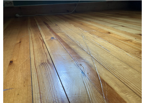
Tregulv med slitasje.
