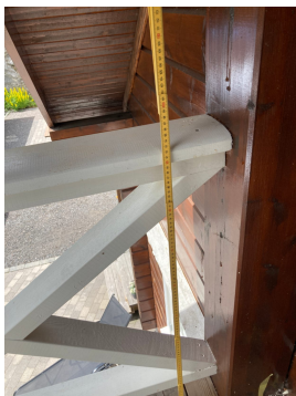
Høyde og åpninger på veranda bør utbedres.
