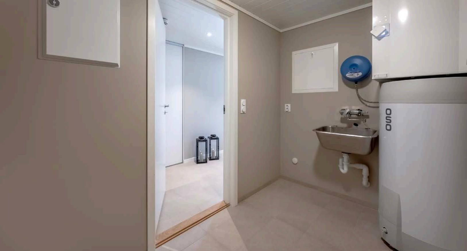
Vaskerom/teknisk rom (1. etasje)
