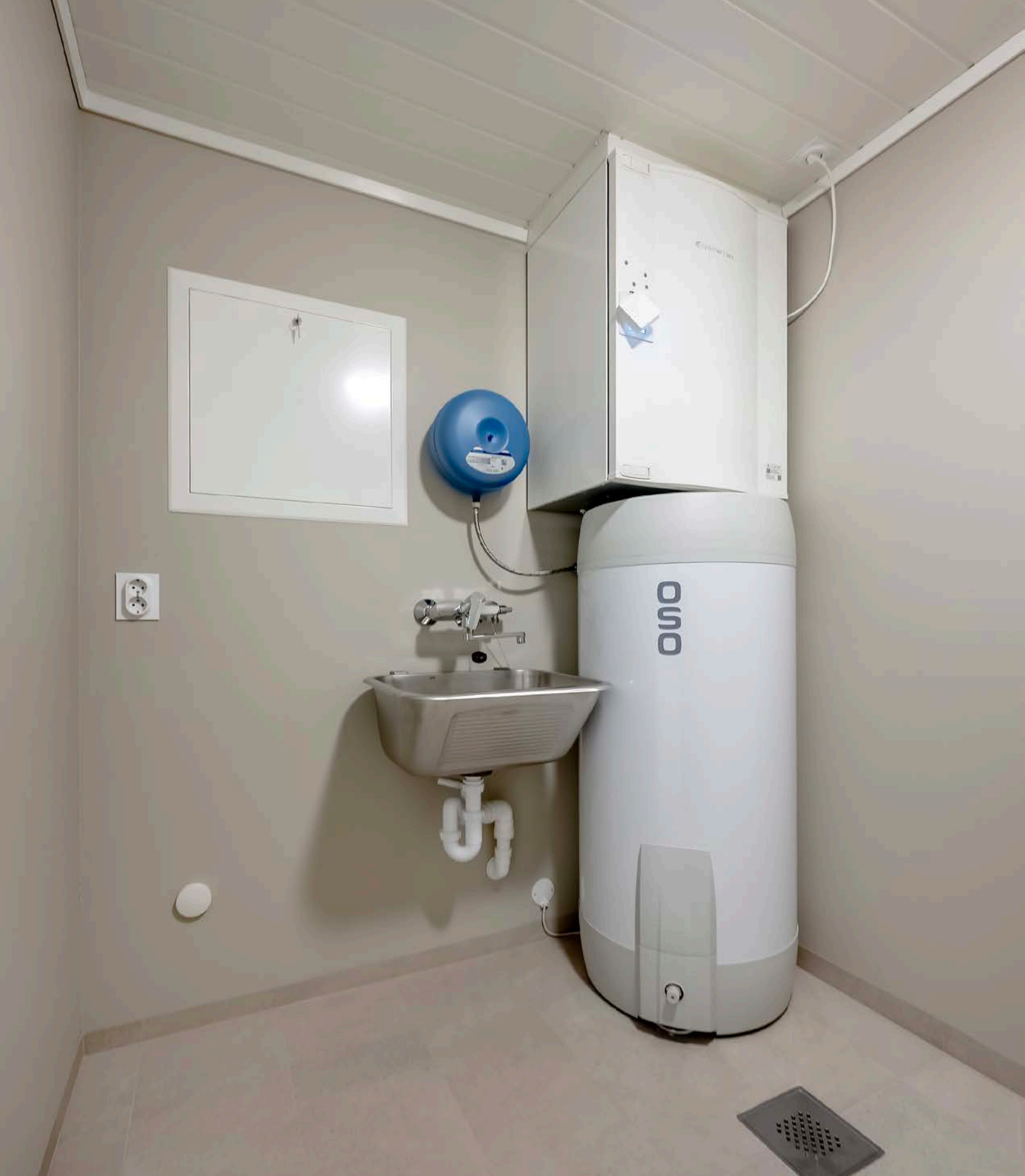
Vaskerom/teknisk rom (1. etasje)
