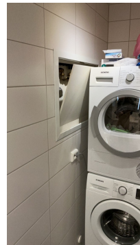
Vannfordelerskap ved siden av tørketrommel.
