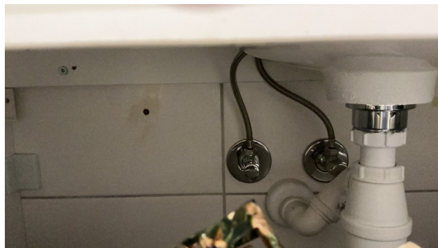
Avløpsrør under servant på bad
