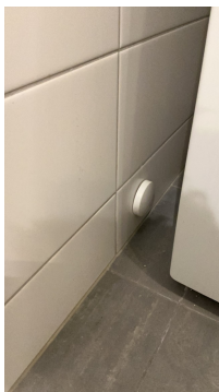
Avrenning for lekkasjevann fra fordelerskap.
