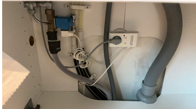
Avløpsrør under kjøkkenvask
