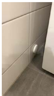
Avrenning for lekkasjevann fra fordelerskap.
