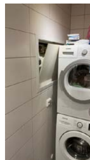
Vannfordelerskap ved siden av tørketrommel.
