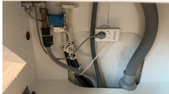
Avløpsrør under kjøkkenvask
