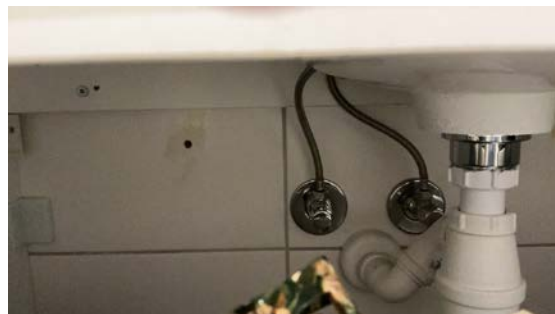
Avløpsrør under servant på bad
