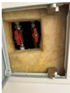
Stoppekran bak luke i himling på bad.
