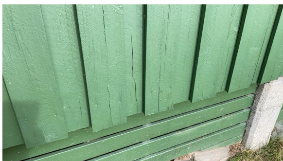
En del sprekker i kledning.
