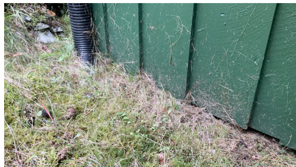
Kledning går helt ned til terreng enkelte steder.
