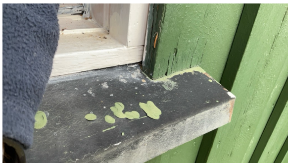
Liten avstand mellom underkant kledning og beslag.
