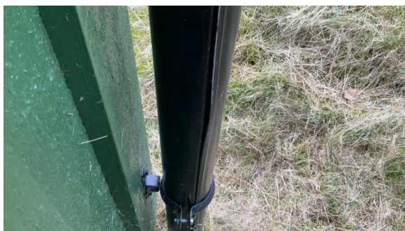
Frostsprengning på nedløpsrør
