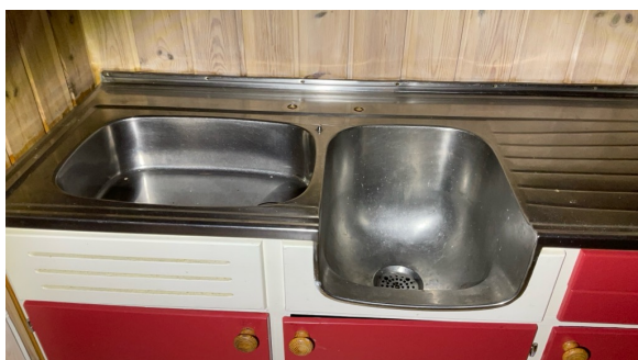
Benkebeslag uten tilkoblet vann og avløp.
