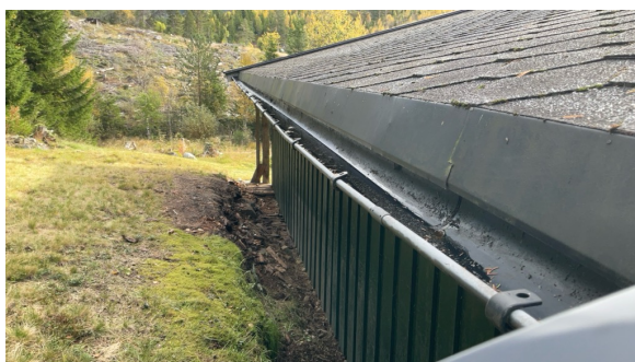
En del nedbøyning på takrenner etter belastning av snø.
