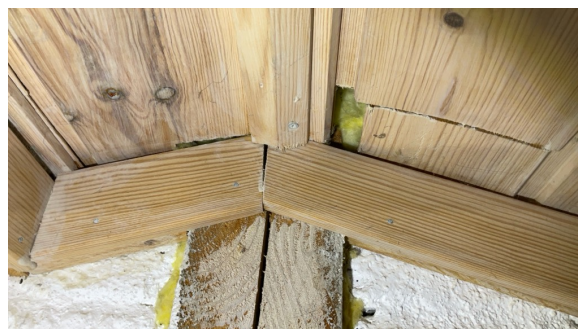
Manglende fungerende dampsperre i tak i soverom inn mot pipe.
