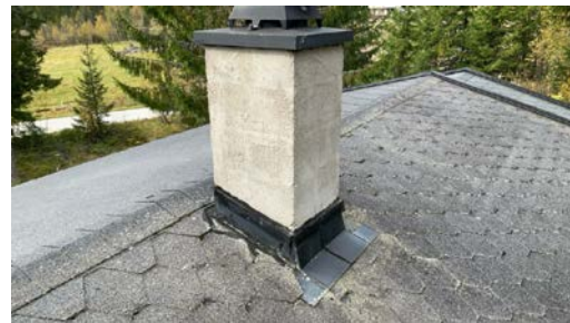
Topp og bunnbeslag på pipe.
