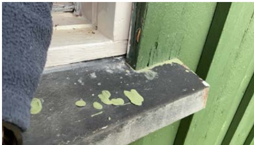
Liten avstand mellom underkant kledning og beslag.
