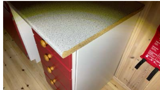
Manglende kantfiner på løs benkeplate.
