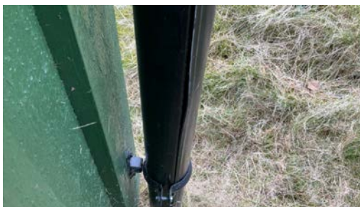
Frostsprengning på nedløpsrør
