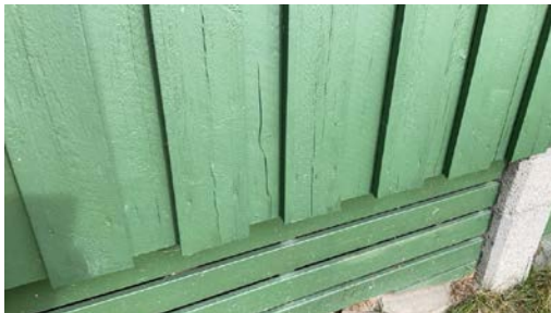
En del sprekker i kledning.
