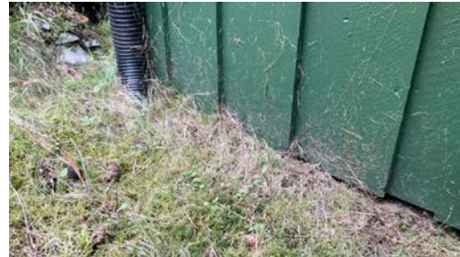
Kledning går helt ned til terreng enkelte steder.
