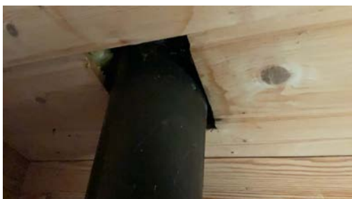
Noe kondensmerker i innvendig tak på toalettrom.
