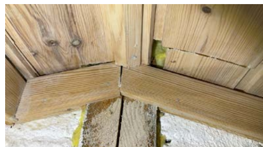
Manglende fungerende dampsperre i tak i soverom inn mot pipe.
