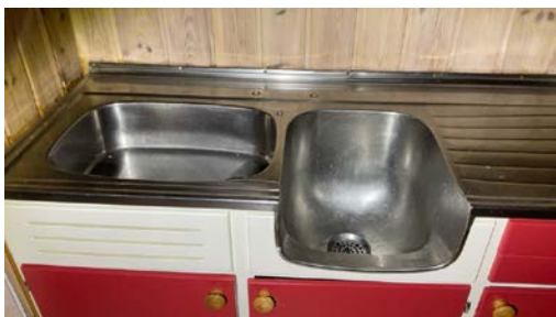
Benkebeslag uten tilkoblet vann og avløp.
