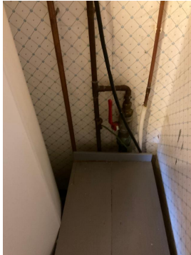
Stoppekrab bak varmtvannsbereder.
