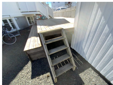
Her må det monteres rekkverk.
