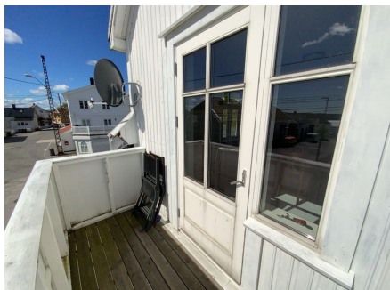
Balkong på ca 4m 2 . Rekkverk målt til 1 meter.
