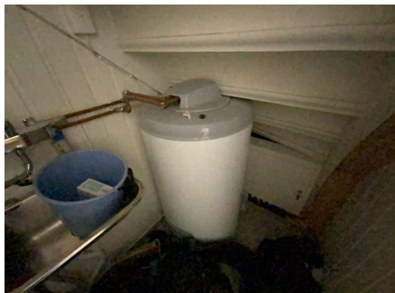
Varmtvannstank i 1. Etasje
