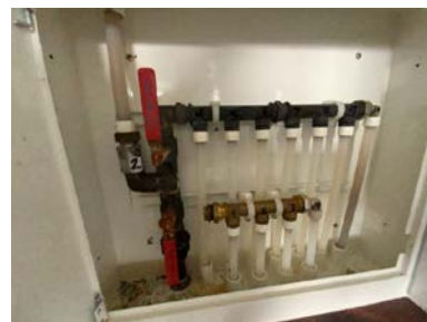
Vannskap i kjeller med stoppekran til begge boenheter.
