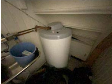
Varmtvannstank i 1. Etasje
