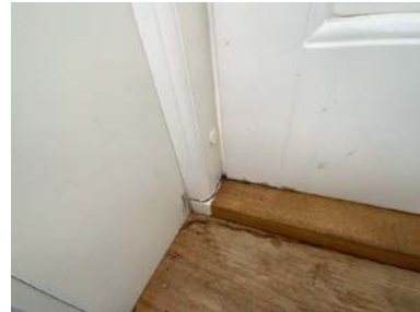
Utett på balkongdør i 2. Etasje
