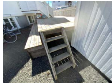
Her må det monteres rekkverk.
