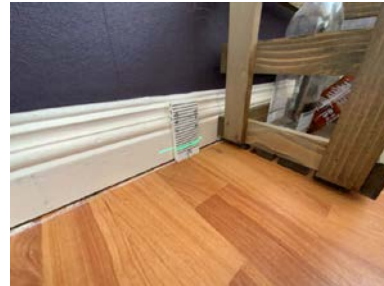
Høydeforskjell på 31mm målt i stue/spisestue i 1. Etasje
