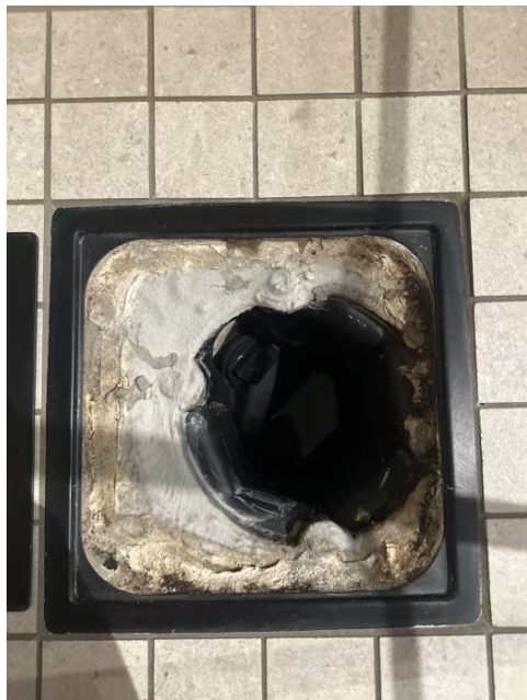
Viser sluk i dusjsonen.
