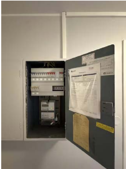
Sikringsskap plassert i felles gang
