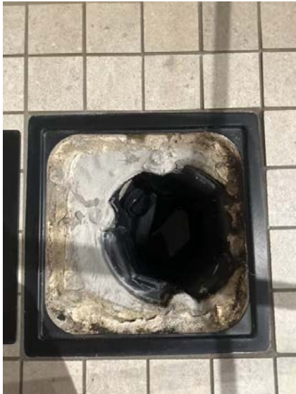
Viser sluk i dusjsonen.
