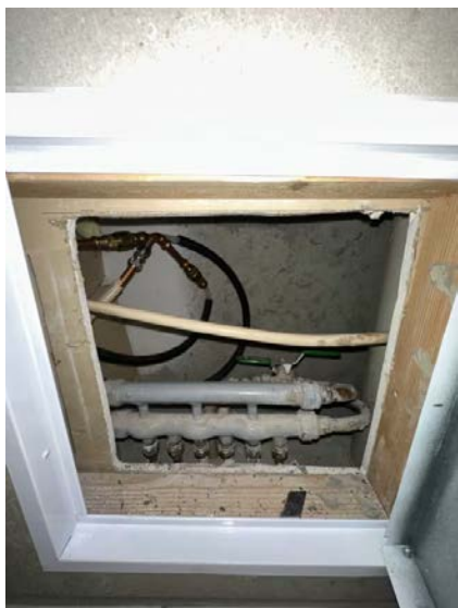
Viser røropplegg med Cu-rør og fordelerstokk med adkomst via inspeksjonsluke på bad.
