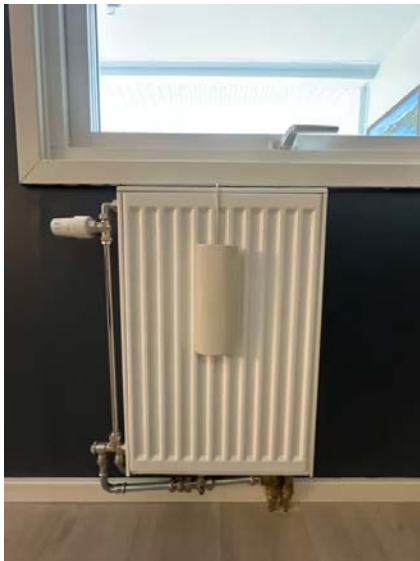
Viser radiator montert på kjøkken. Pyntekopper rundt rørgjennomføringer.
