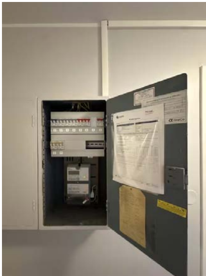
Sikringsskap plassert i felles gang
