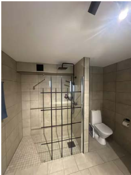
Viser dusjvegg i glass, veggmontert termostatbatteri og dusjgarnityr. Gulvstående toalett.
