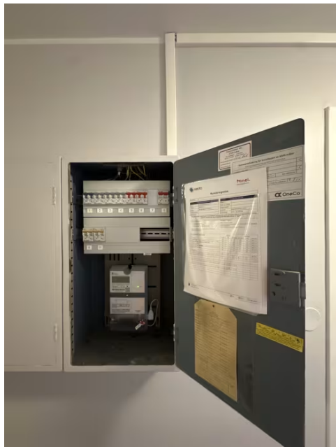
Sikringsskap plassert i felles gang
