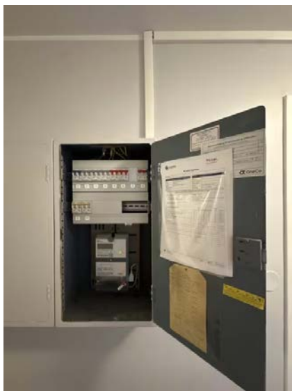
Sikringsskap plassert i felles gang
