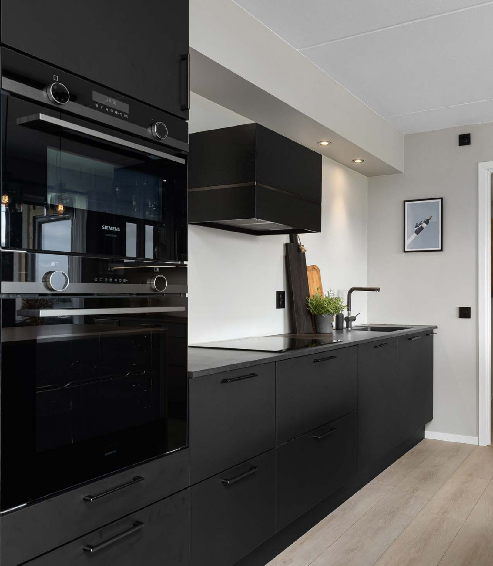
Ventilator med kullfilter over komfyr fra 2021, type Rørshetta.
