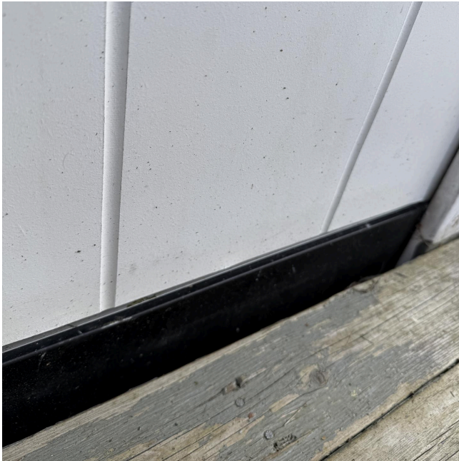
Fuktskade i bunnen av ytterdør.
