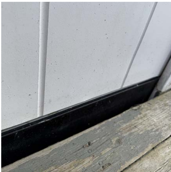
Fuktskade i bunnen av ytterdør.
