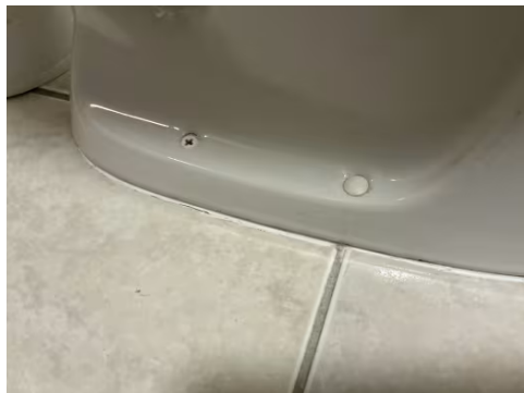
Toalett er festet til gulv med skruer og membran er punktert.
