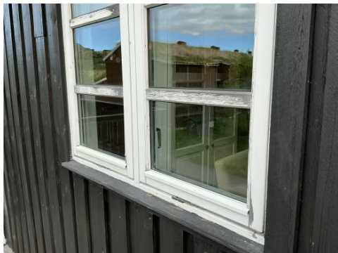
Utvendig vindu fremstår som slitt.
