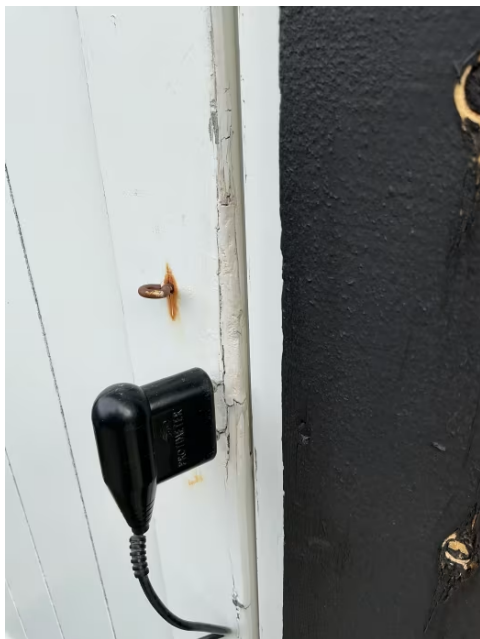
Større sprekker/skade på dørbord til terrassedør TG 3.
