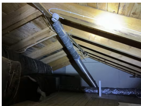
Ventilasjons-kanal er ikke isolert.
