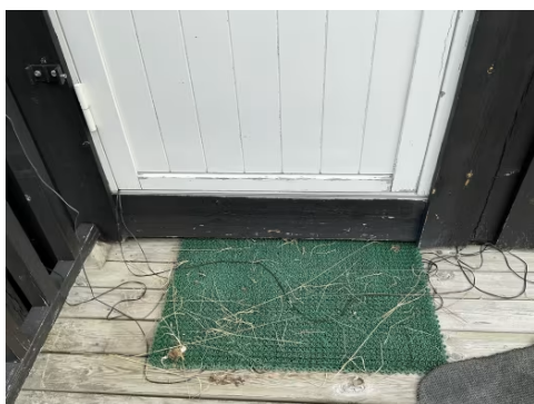
Beslag ved terskel er ikke montert.
