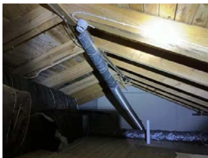
Ventilasjons-kanal er ikke isolert.
