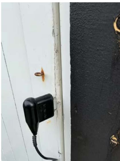
Større sprekker/skade på dørblad til terrassedør TG 3.
