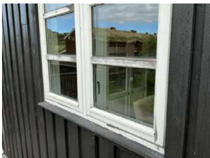
Utvendig vindu fremstår som slitt.
