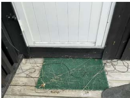
Beslag ved terskel er ikke montert.
