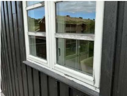
Utvendig vindu fremstår som slitt.
