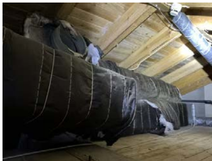
Rester etter ventilasjons-kanaler på kaldt loft.
