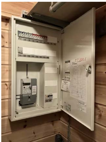
Sikringsskap står i vaskerom.
