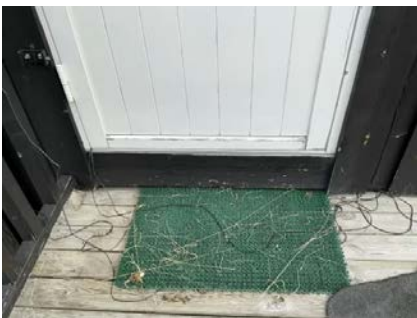
Beslag ved terskel er ikke montert.
