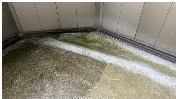
Belegget er løst enkelte steder
