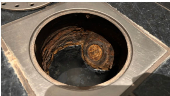
Eldre sluk i støpejern
