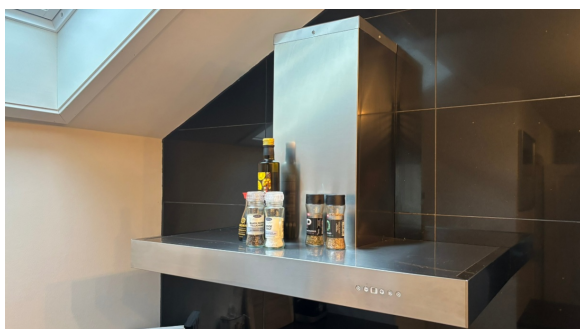
Ventilator med avtrekk tilkoblet kullfilter
