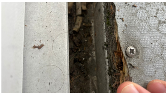
Råteskader under belegget
