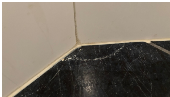
Sprekker på noen fliser i dusjnisen
