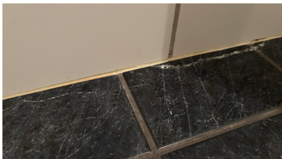
Sprekker på noen fliser i dusjnisen
