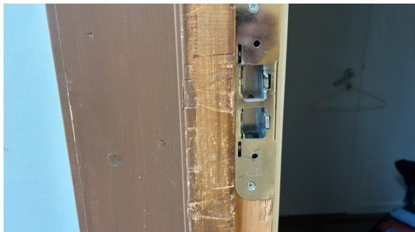
Merker på ytterdøren
