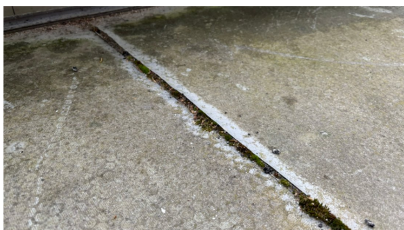
Utette skjører på belegget
