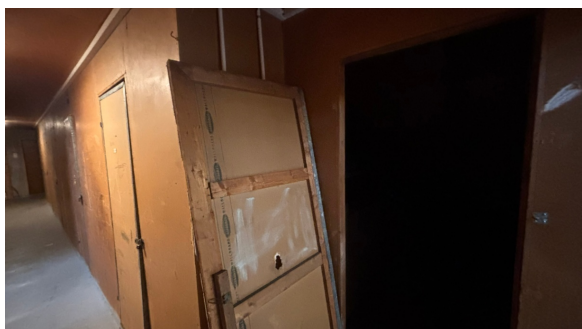
Døren til boden var løs på befaringen
