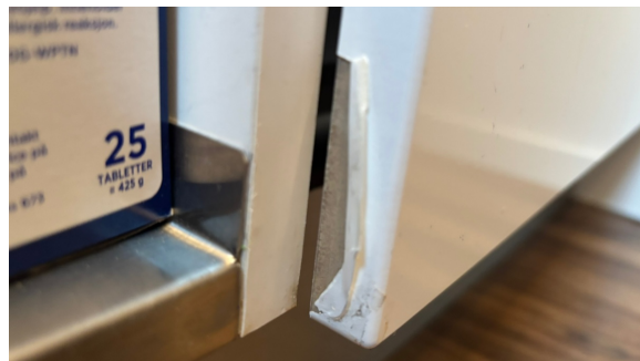
Sprekker i folieringen på kjøkkenet
