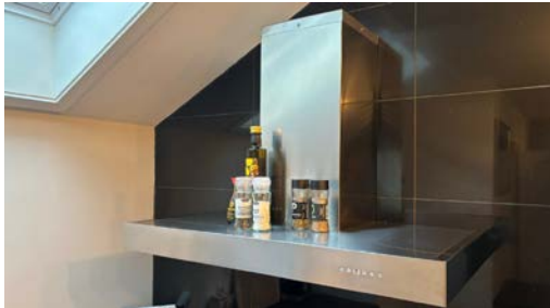
Ventilator med avtrekk tilkoblet kullfilter
