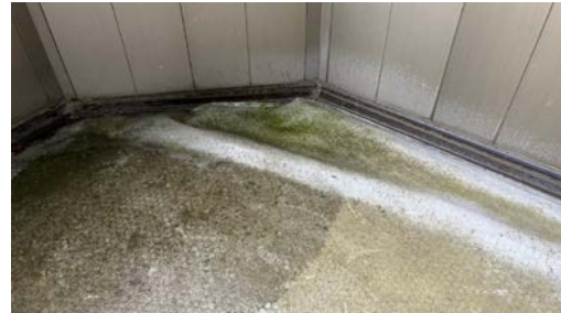
Belegget er løst enkelte steder
