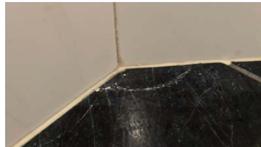
Sprekker på noen fliser i dusjnisen
