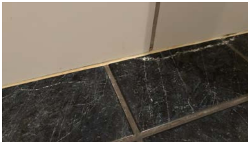
Sprekker på noen fliser i dusjnisen
