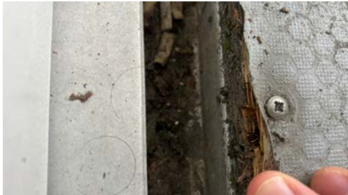
Råteskader under belegget
